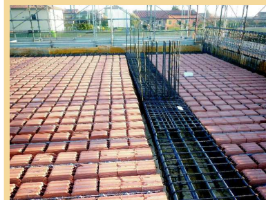
Solaio del primo piano fuori terra dettaglio di posa dei travetti armati per il successivo getto di calcestruzzo, in primo piano l'armatura delle travi in c.a. per il sostegno dell'intera struttura.
