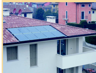
Pannelli fotovoltaici , dettaglio della posa sul fronte sud della copertura di un fabbricato.
