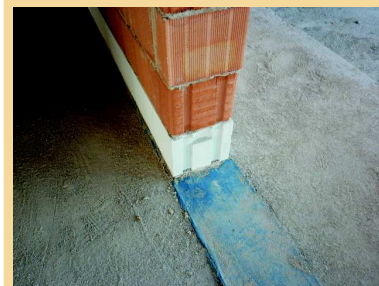
Guaina impermeabilizzante , posata a contatto con il solaio del piano terra per evitare la risalita dell'umidità.
